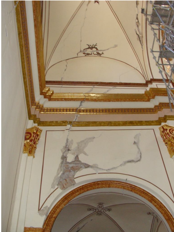
Nave lateral de la iglesia completamente agrietada.
