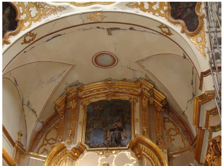
Estado actual de la parte superior del altar mayor.
