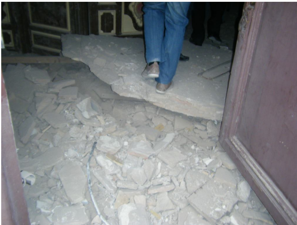
Entrada principal de la iglesia tras el desprendimiento del techo.
