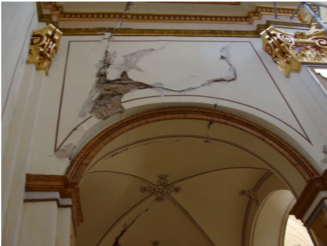
Desprendimientos en paredes laterales.
