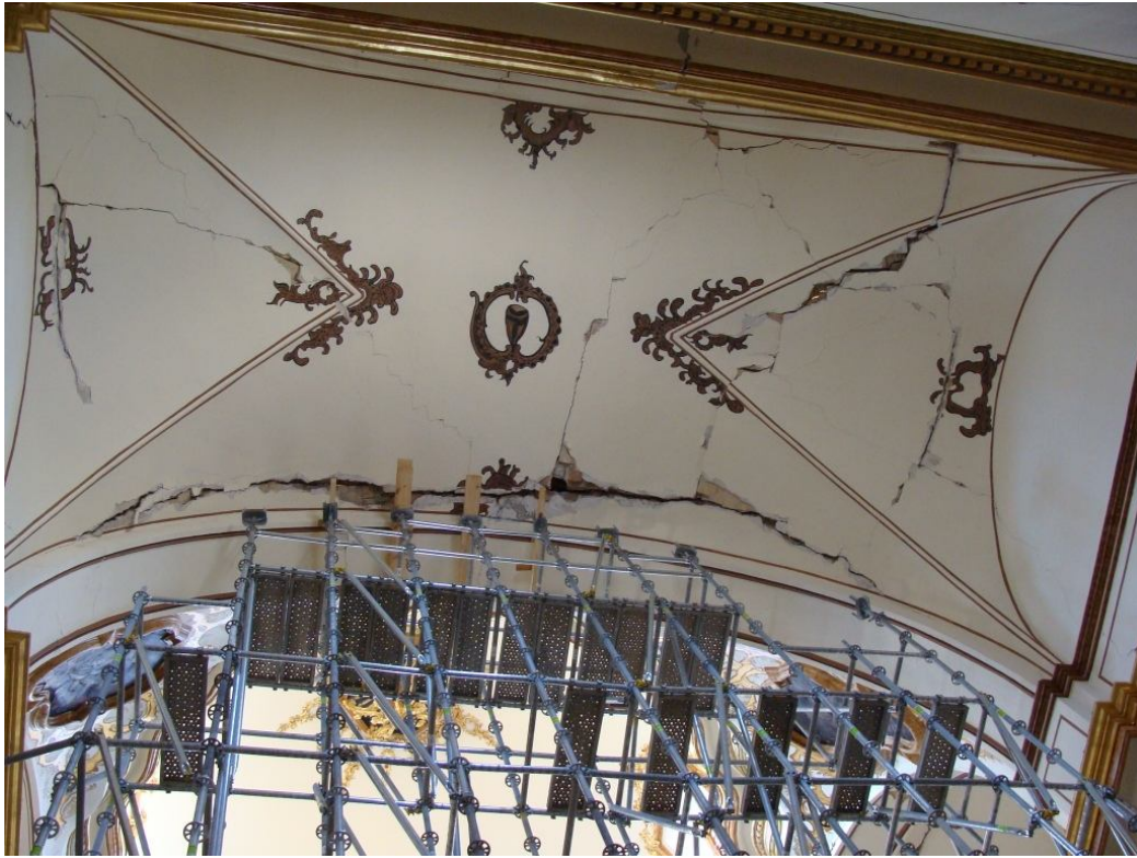
Estado de una de las bóvedas laterales.
