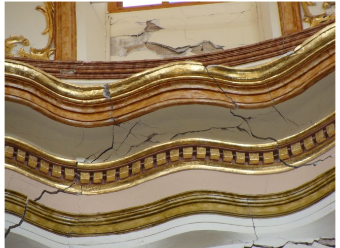
Detalle del anillo de la cúpula destrozado.
