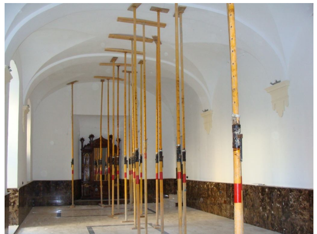
Sacristía de la parroquia totalmente apuntalada.
