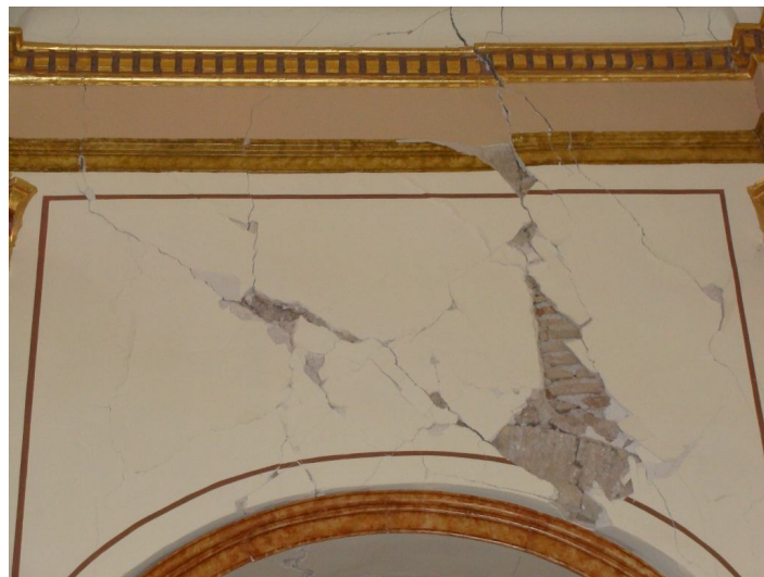
Estado de una de las paredes laterales.
