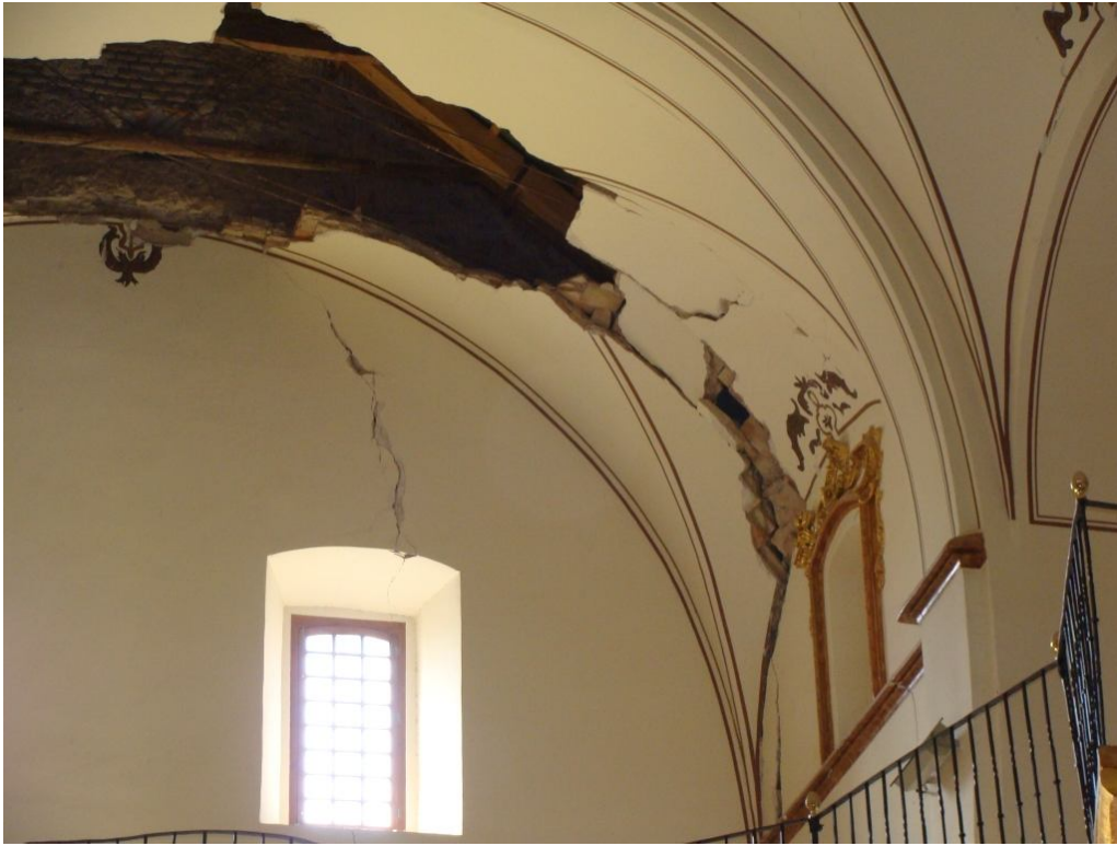
Desprendimiento de la bóveda superior al coro.
