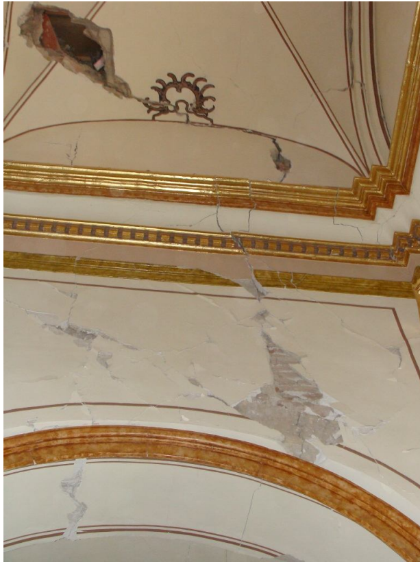
Pared nave lateral completamente fragmentada.
