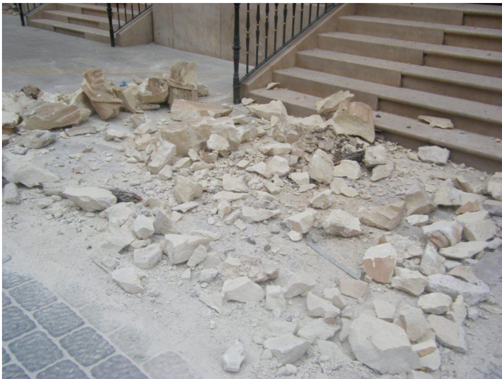
Fragmentos de los desprendimientos de los Santos y ornamentos de la fachada principal.
