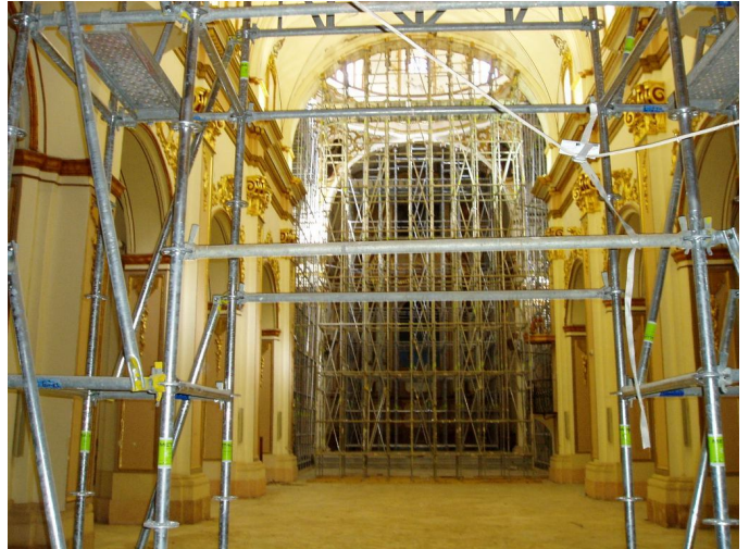
Nave central tras los seísmos, totalmente apuntalada.
