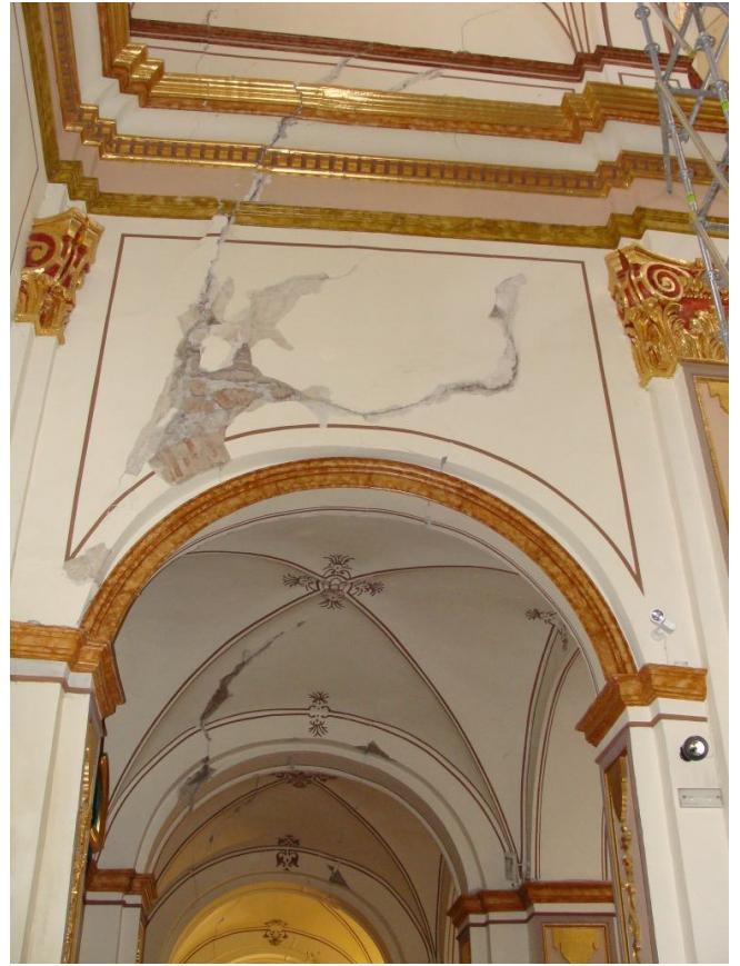
Estado actual de las capillas laterales con todos sus arcos y cúpulas fragmentados.
