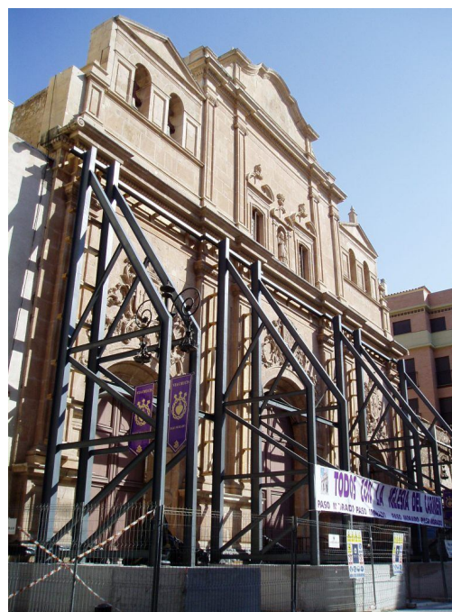
Fachada principal apuntalada y sin los ornamentos y santos que la presidían.
